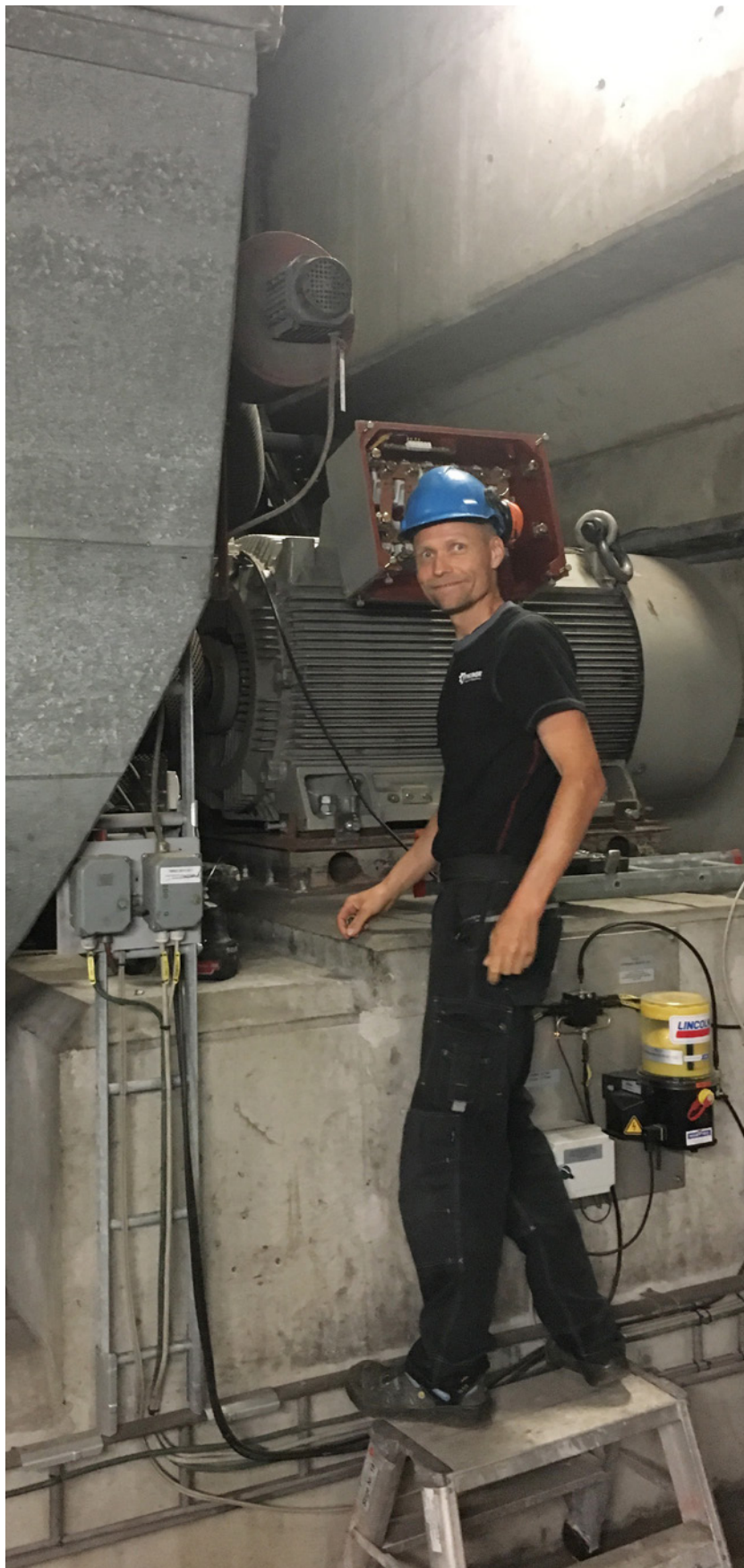
630 kW motor til sugetræksblæser får skiftet leje. Til daglig står motoren på Verdos kraftvarmeværk i Randers. Nu er den blevet reoveret af PRONOR IndustriTeknik, som er servicepartner for Verdo, når det gælder elmotorer, gear og pumper.
